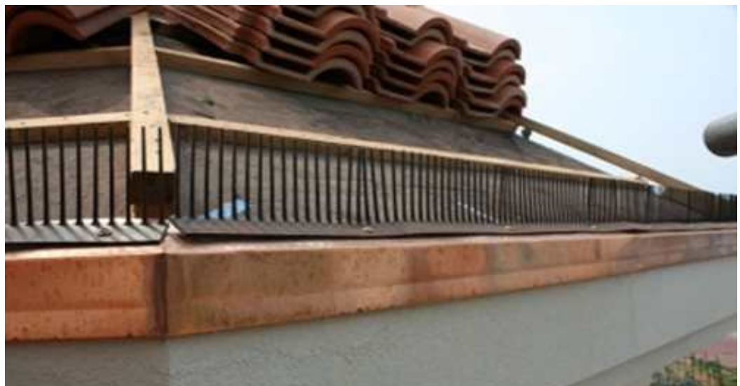
처마끝단에 설치된 새막이(버드스탑) 설치 형태
